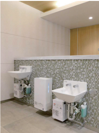
女性トイレ 洗面コーナー
