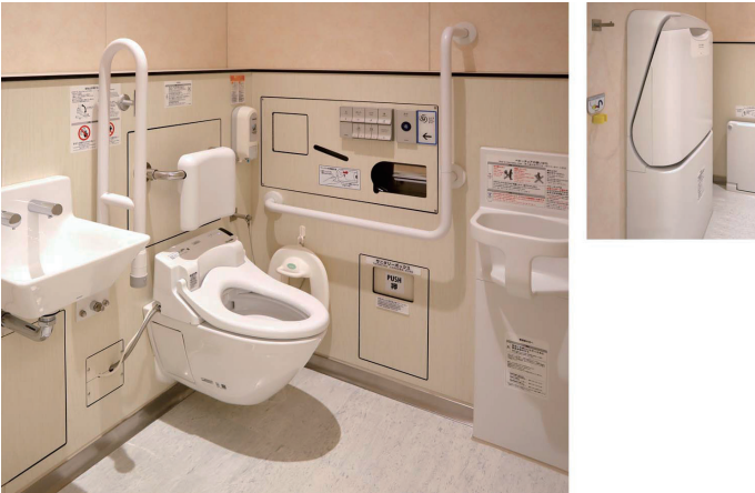
女性トイレ ひろびろブース
