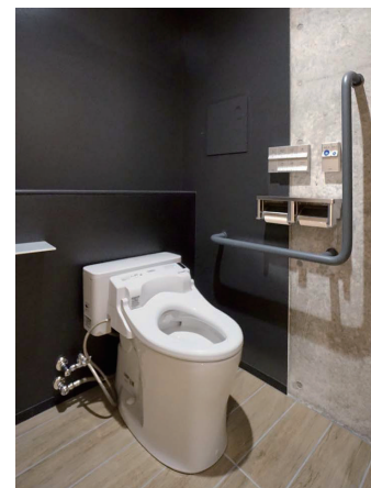
1F女性トイレ ひろびろブース
