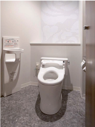
女性トイレ 大便器コーナー
