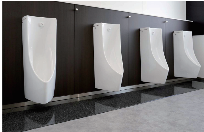
本館3F 男性トイレ 小便器コーナー
