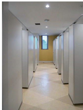
1F北 女子トイレ 大便器ブース
