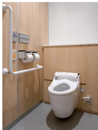
女性採尿用トイレ 大便器ブース
