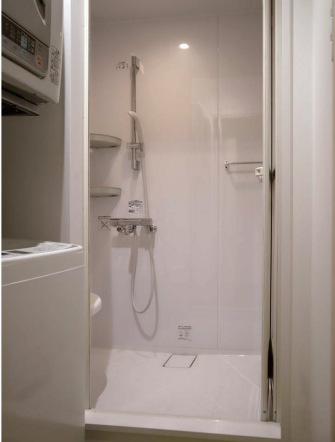
保健室には、ウォシュレットを設置した個室完結型のトイレとシャワーブースを設置している。
