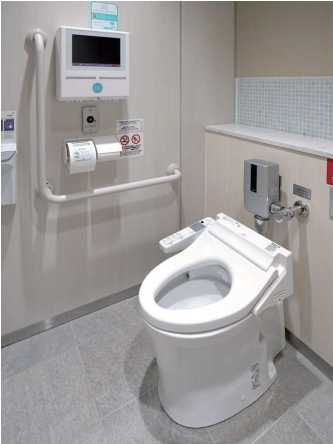
2F北女性トイレ ベビーカー対応ブース
