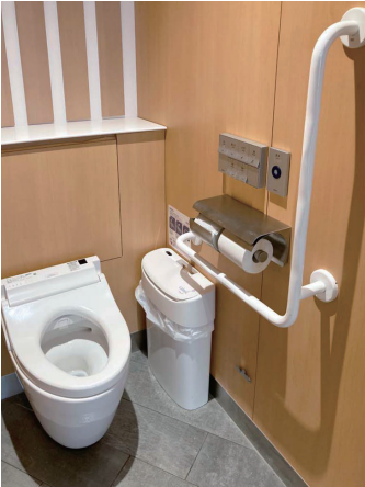
女性トイレ 大便器コーナー
