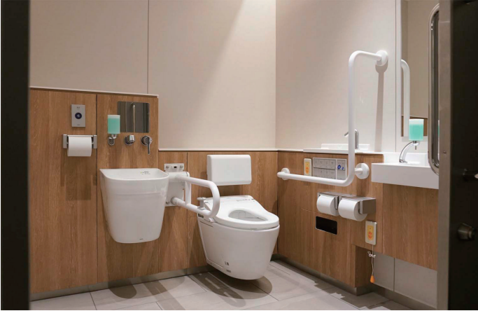
西側トイレ バリアフリースイッチ
