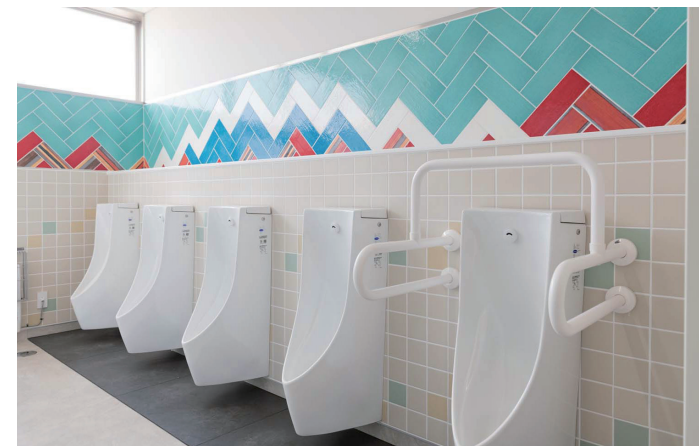
3F北トイレ 小便器コーナー
