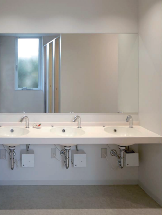
女性トイレ 洗面コーナー
