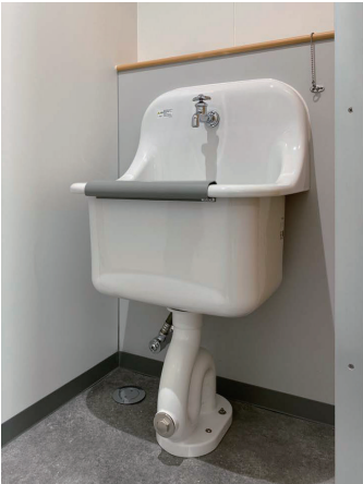
生徒用トイレ 掃除流し・ 掃除道具入れ
