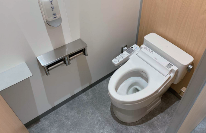
生徒用トイレ 大便器ブース
