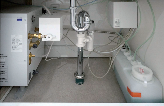
女性トイレ 洗面コーナー
