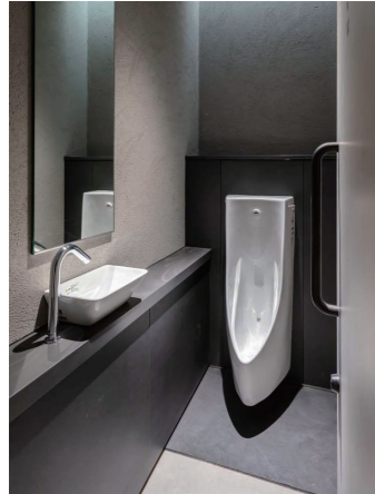
ファクトリーエリア 小便器
