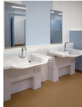
中央棟1F 男子トイレ 洗面・小便器コーナー
