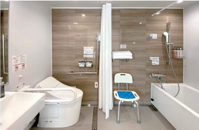
ユニバーサルルーム 水まわり
