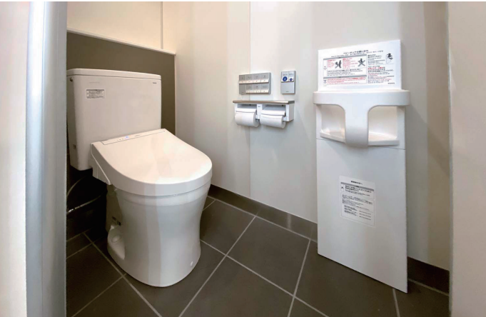
男性トイレ 大便秘器ブース
