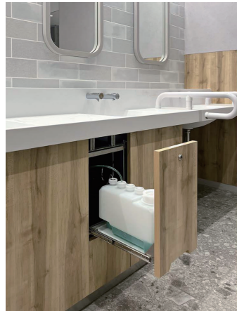
女性トイレ 洗面コーナー
