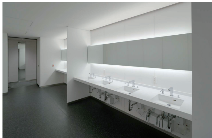
2F 女性トイレ 洗面・スタイリングコーナー
